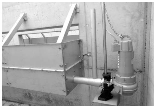
Bild 7: Blick auf Abwassertauchmotorpumpe / Luftansaugrohr / Mischdüse
