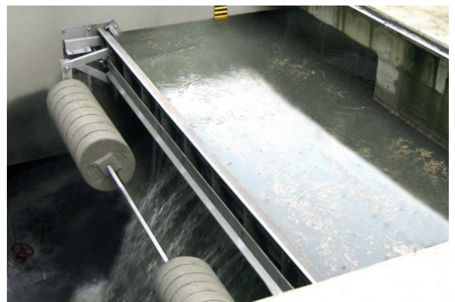
RÜ-Stauklappe H im Einsatz (3-seitige Abdichtung)
