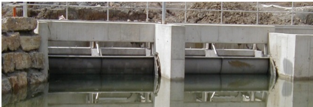
Bild 4: RÜ-Stauklappe SG an offenem Speicherbecken
