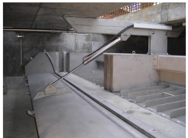
Bild 6: RÜ-Stauklappe SG komplett geöffnet mit vorgeschaltetem RÜ-Feinsiebrechen.
