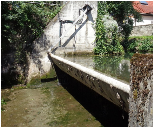
Bild 2: RÜ-Stauklappe SG als Fluss-Stauwehr im Einsatz
