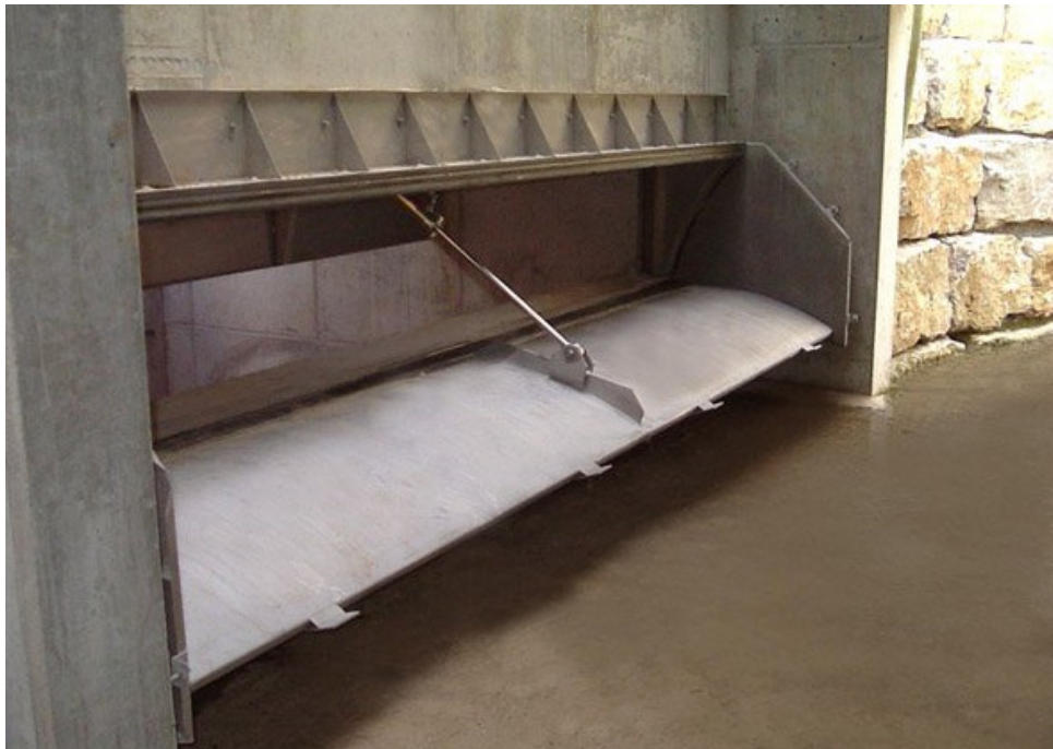
Bild 5: RÜ-Stauklappe SG komplett geöffnet mit vorgeschalteter Tauchwand
